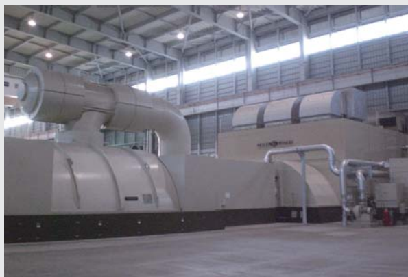
▲ 富津火力発電所4-1軸パワートレイン Power train of Futtsu Thermal Power Station Unit 4-1
