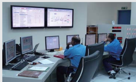
◀ 中央操作室 Central control room
